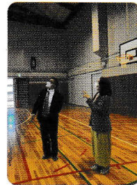
体育館の屋根は雨漏りのため継ぎ接ぎにて修復の繰り返し。
