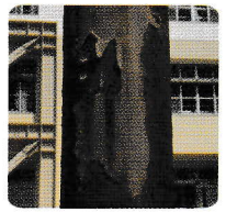
使用していない電灯が数本、撤去されずにさびついている。
